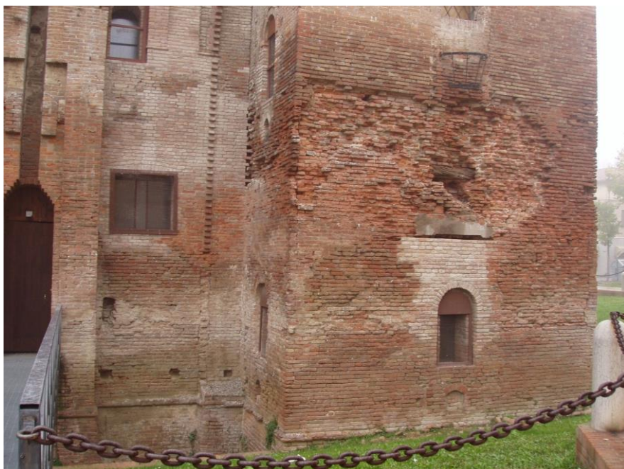
Fig. 24 – Particolare della torre sud – est; ben evidente è la caduta di mattoni e la trave in legno messa in luce.
