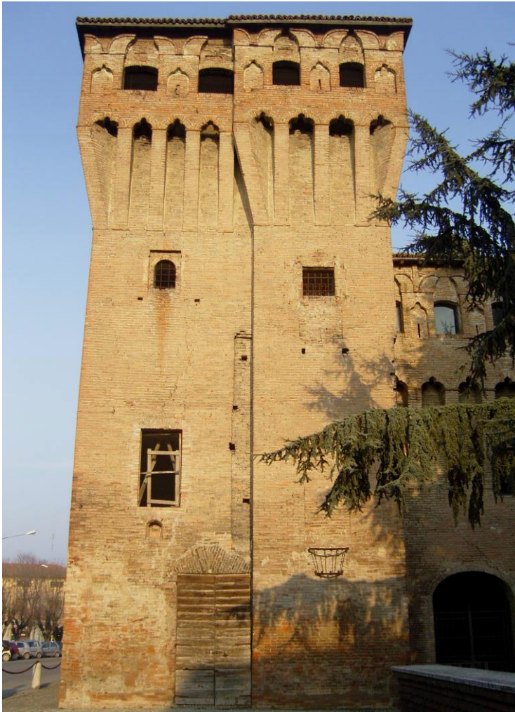
Fig. 17 – Torre angolare. Si possono notare le tracce della muratura abbattute (USM 427), la macchia di umidità e lo “ scasso “ ( USM 425 ) tra le due torri.
