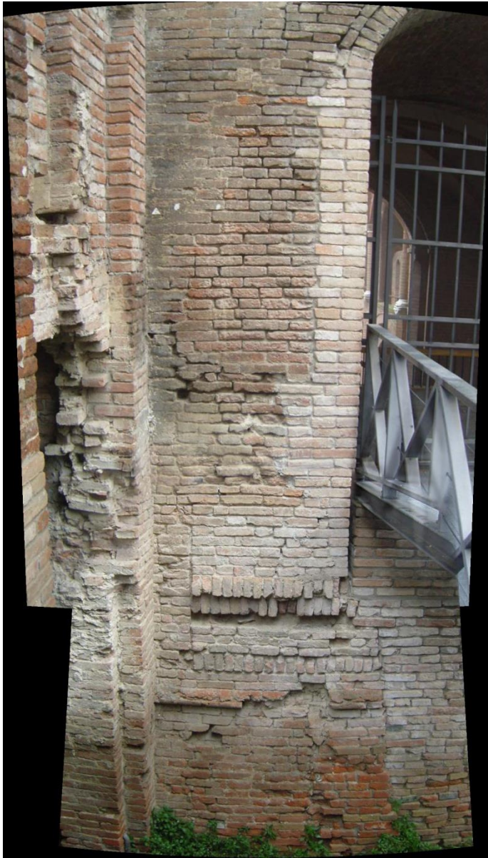
Fig. 20 – Tre file di laterizi sistemati di testa nella zona sottostante la porta, possibile base di una porta o di una finestra.
